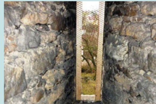
Durch die Vergitterung gegen Tauben wurden nahezu alle Zugänge zum Turm und zum Dachgeschoss versperrt. Die Zielarten konnten diese Quartiere nicht mehr nutzen.
