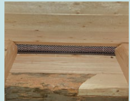
Abbildung 13: Unnötig und schädlich: Insektenabwehrbleche an den Dachtraufen: Insekten kommen ungehindert durch, Kleinvögel, Mauersegler und Fledermäuse werden ausgesperrt, Tauben kommen durch die engen Schlitzlöcher ohnehin nicht durch.
