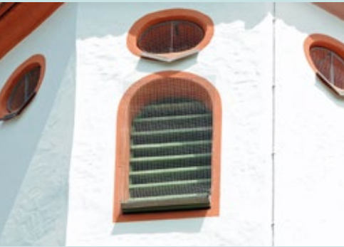
Abbildung 6: Effiziente Taubenabwehr durch vollflächige Vergitterung aller Öffnungen. Damit sind aber auch alle anderen bauwerksbesiedelnden Vogel- und Fledermausarten ausgesperrt. Die Lebensraumfunktion wurde vollständig zerstört.
