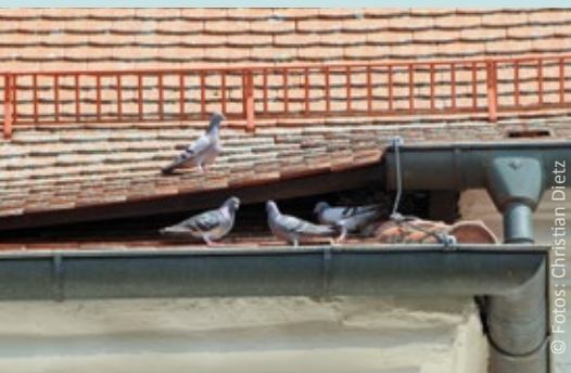
Abbildung 2: Über Öffnungen gelangen Haustauben ins Gebäudeinnere und können dort brüten.
