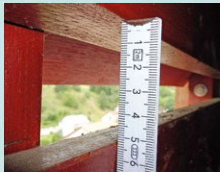
Abb. 22: Keine Angst vor Spaltweiten um 5 Zentimeter: sind durch eine konstruktive Anpassung der Simsen vor den Schallläden keine Sitzmöglichkeiten vorhanden, kommen Tauben nicht hindurch.
