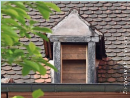
Abbildung 21: Versetzt angebrachte senkrechte Bretter bilden eine Einflugöffnung für die manövrierfähigen Fledermausarten, Tauben werden zuverlässig ausgesperrt.
