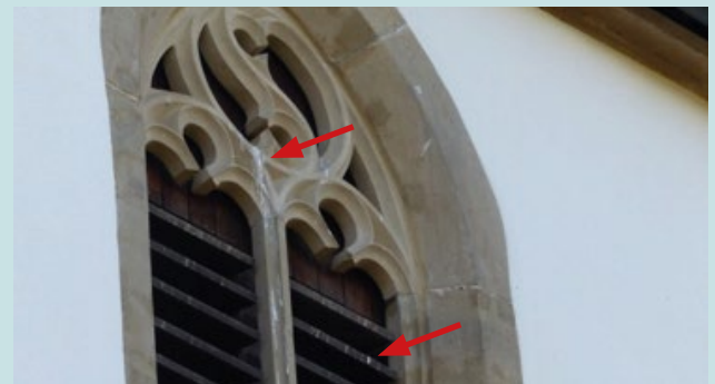
Kotspuren an angrenzenden Bauteilen wie z. B. Schallläden und Ziergewände
