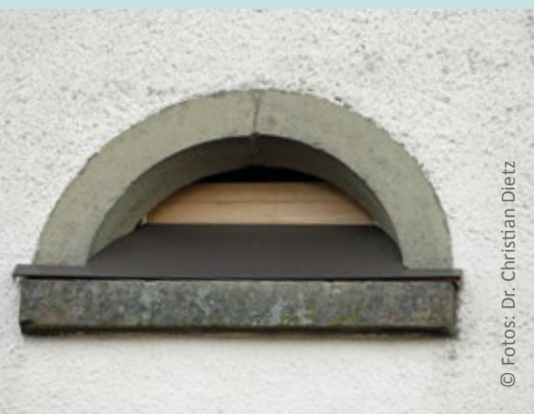
Abbildung 10: Artenschutzverträgliche Taubenabwehr: Der 45° geneigte aufgesetzte Blechsims verhindert wirksam das Anlanden durch Tauben, Regenwasser fließt ab und durch den ins abgedunkelte Gebäudeinnere führenden Einflugschlitz können Fledermäuse ins Quartier gelangen.
